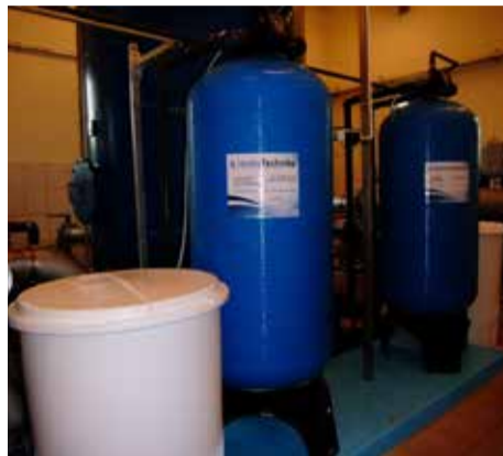
Stacja zmiękczenia wody
